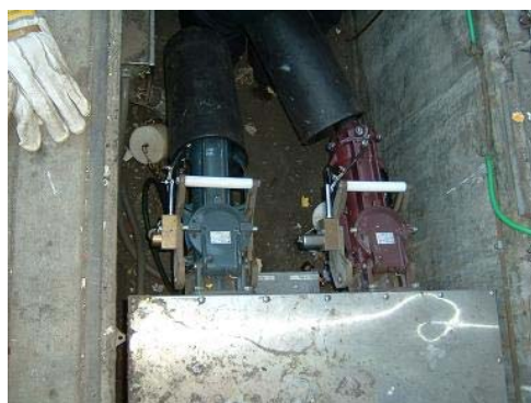
電源プラグの接続 (陸側)
